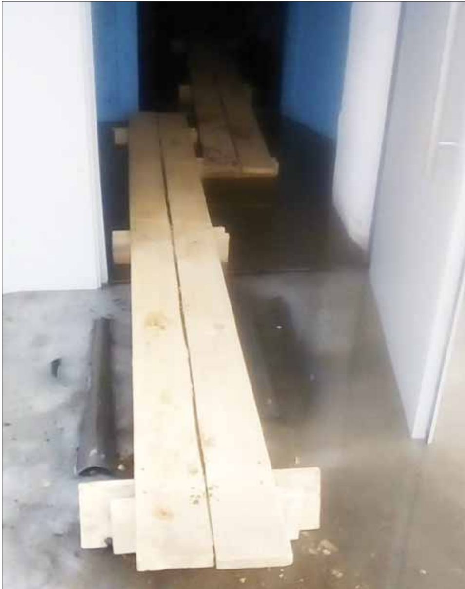
Вот такая запруда образовалась около дома и внутри подъезда
